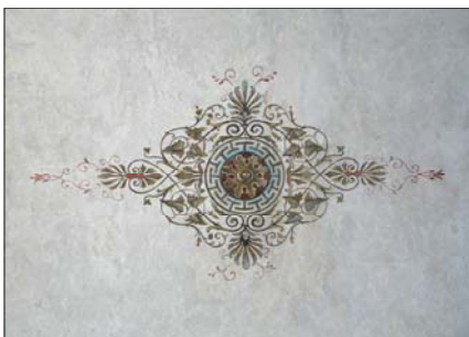
7 7 Detail štukové výzdoby klenby v místnosti 8 dnešní knihovny před restaurováním, stav 2008, foto J. Štáblová
