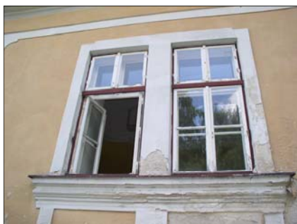
66 Soustředěná okna před rekonstrukcí
